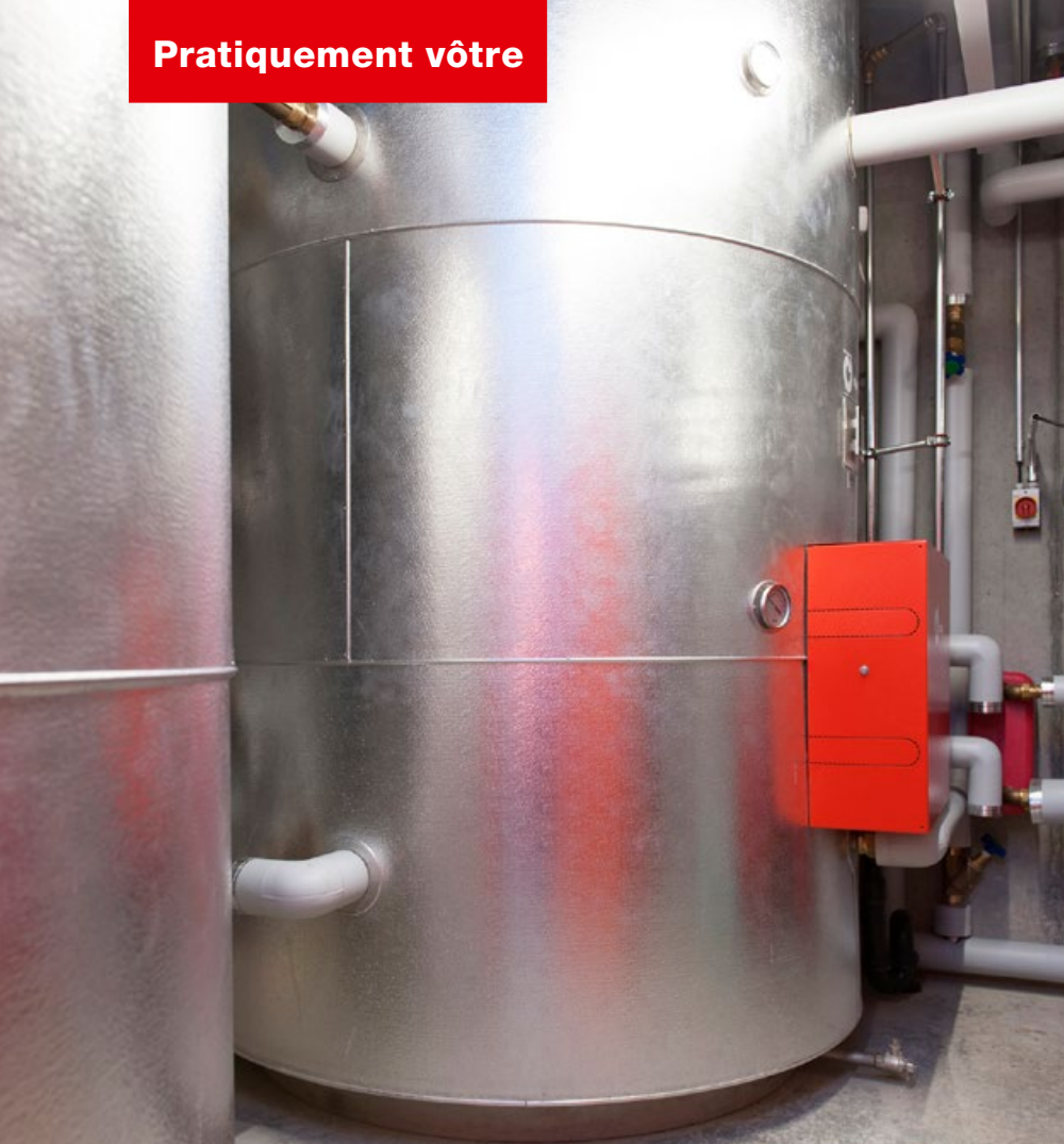
Gigantesque: les deux gros accumulateurs solaires de 5000 litres abrités dans le local technique du Modern Times Hotel
