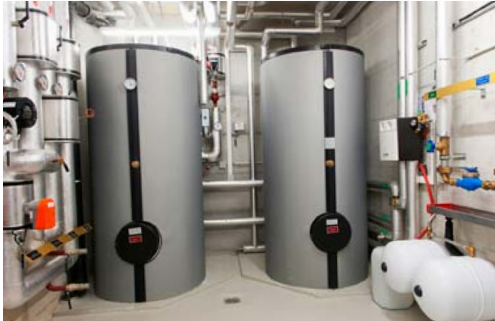
Hochmoderne Speichertechnik als Basis für nachhaltigen Wohnkomfort
