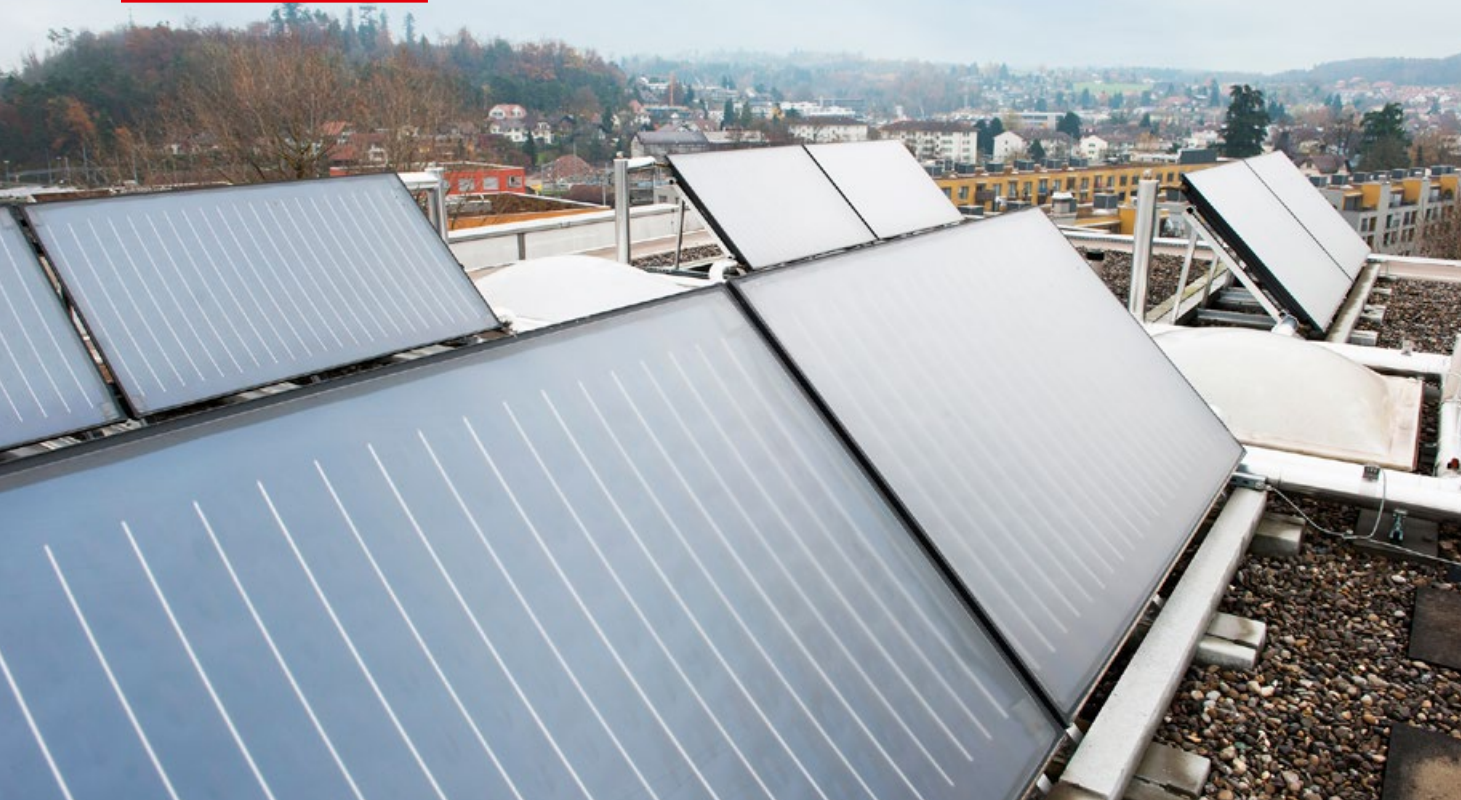
Beeindruckend: 37,5% des Warmwasserbedarfs wird durch die Kraft der Sonne abgedeckt.
