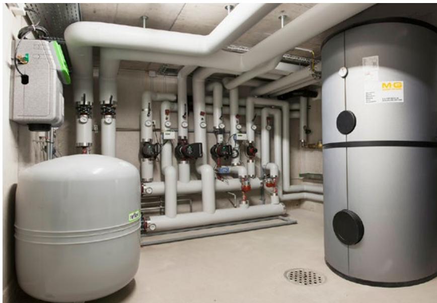
Im Technikraum sorgt die Fernwärmeübergabestation von Tobler für Wärme nach Mass.
