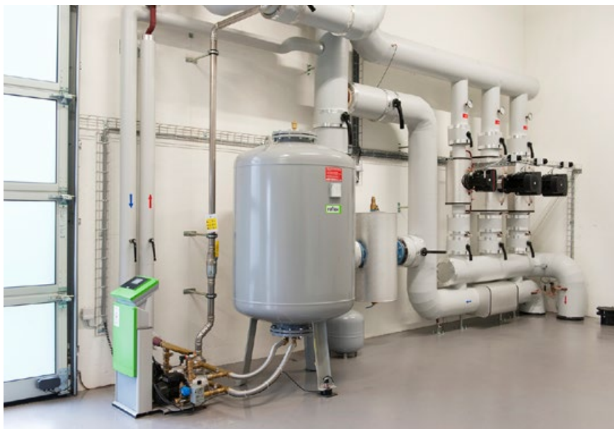
Beeindruckende Dimensionen: Die haustechnische Anlage in der Energiezentrale der Überbauung Beundenpark.
