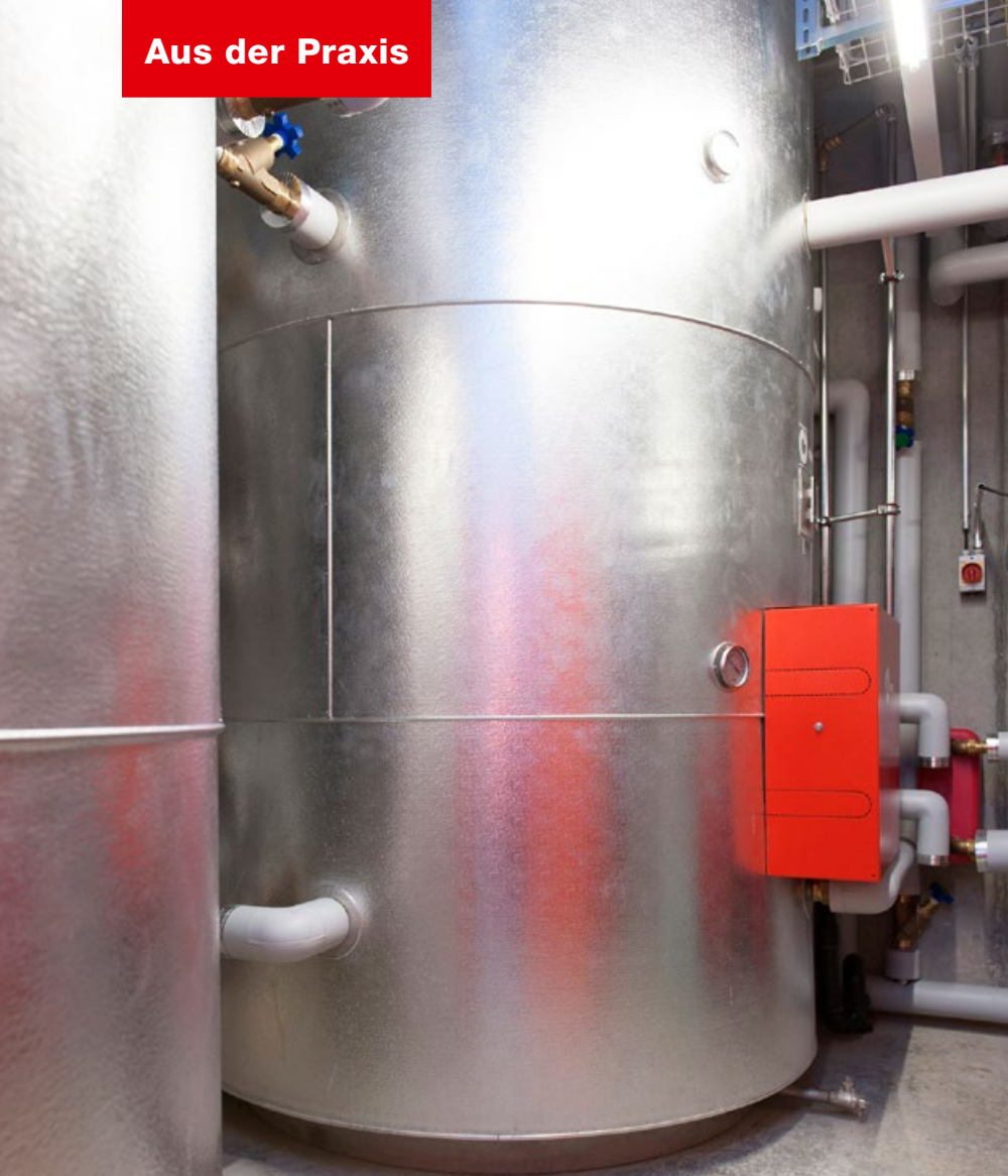
Gigantisch: Die zwei 5000l grossen Solarspeicher im Technikraum des Modern Times Hotel
